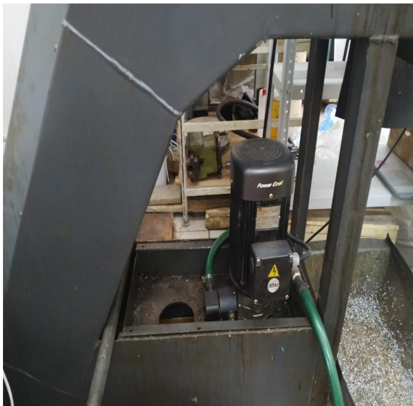
Неисправность системы подачи СОЖ
