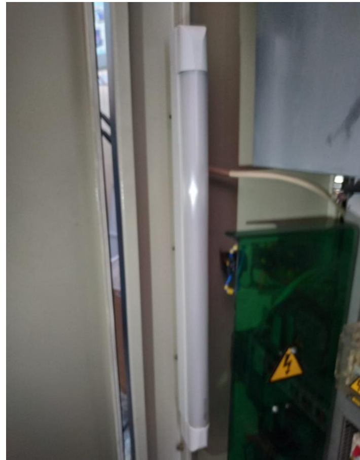
Неисправность освещения электрошкафа
